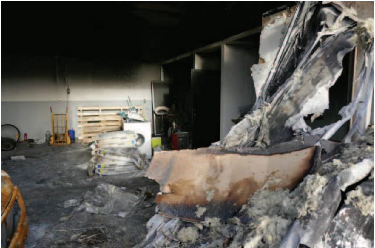
Bild 6. Sotskador på väggar och tak inne i verkstaden.
