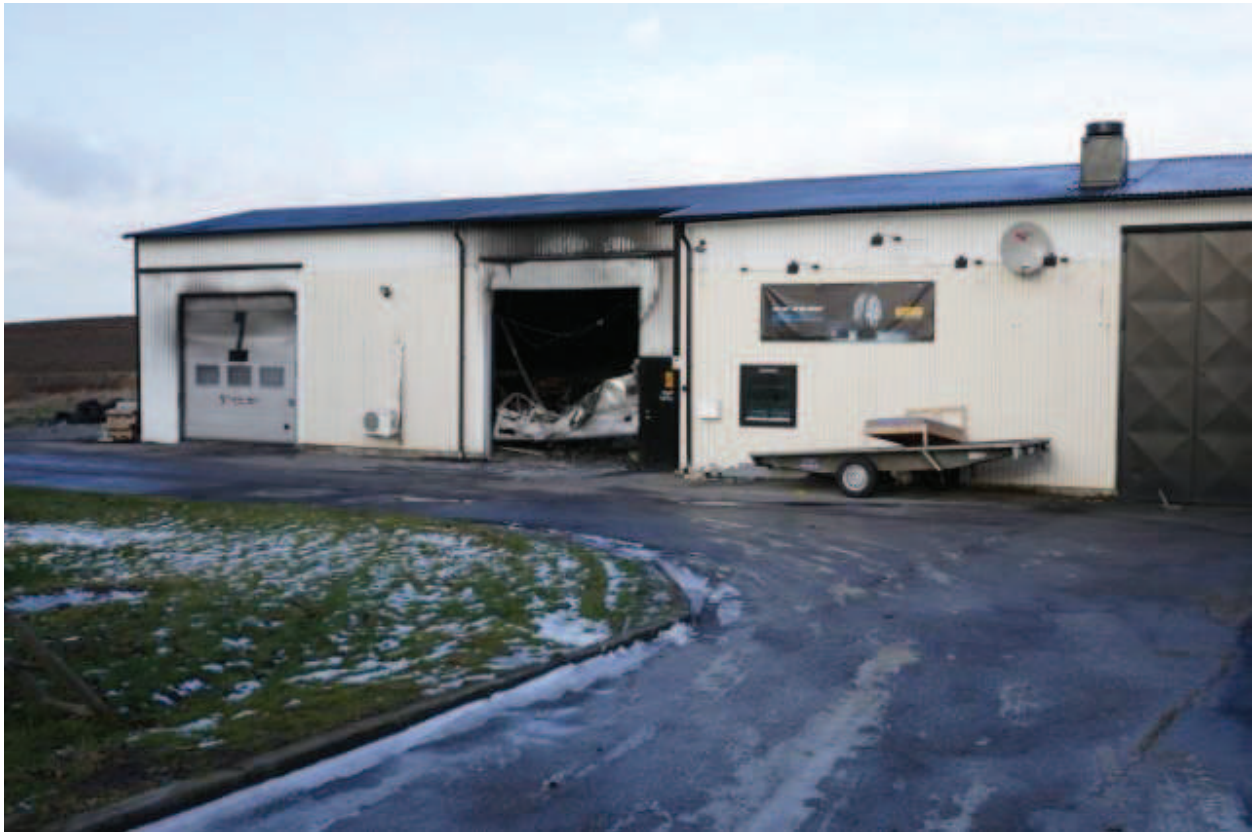
Bild 3. Brandskadad port och sotskador på plåtfasaden.
