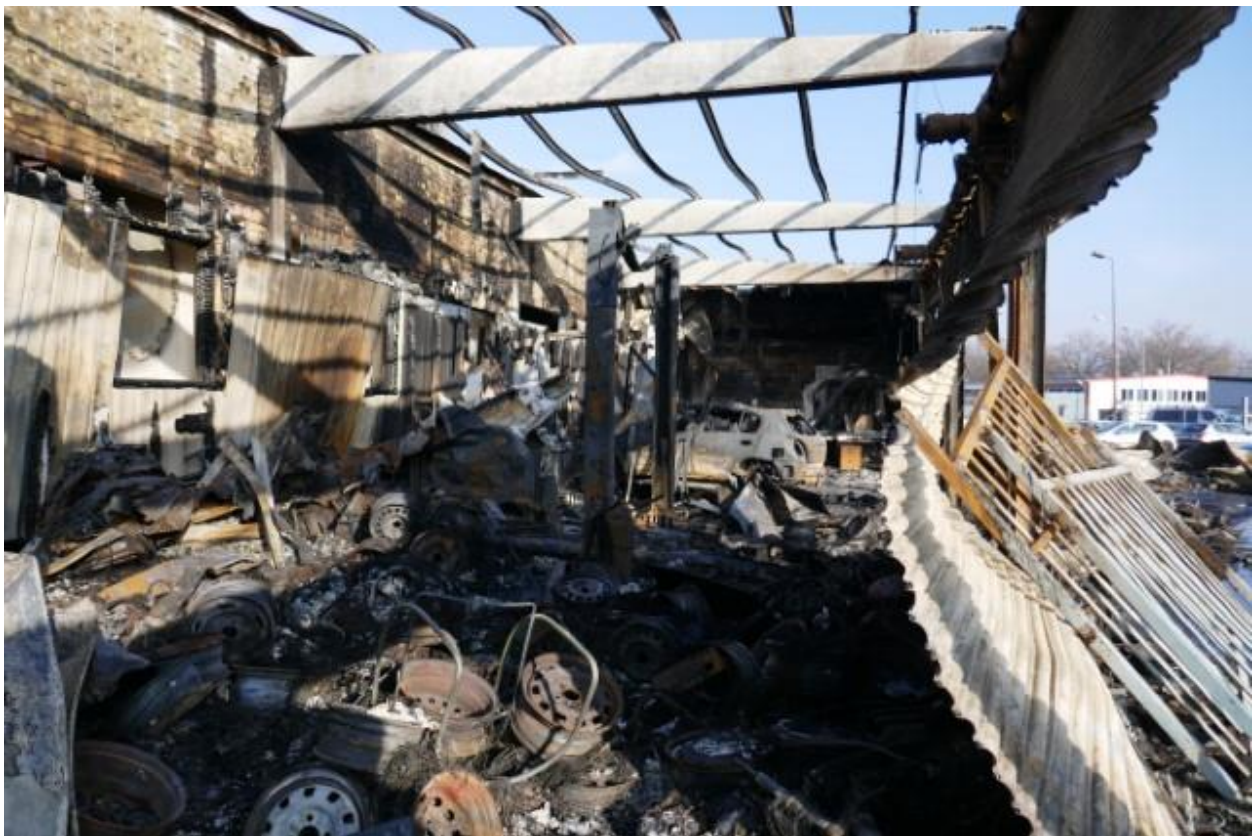
Bild 4. Stålbalkar i taket som tappat form och bärlighet efter kraftig värmepåverkan.
