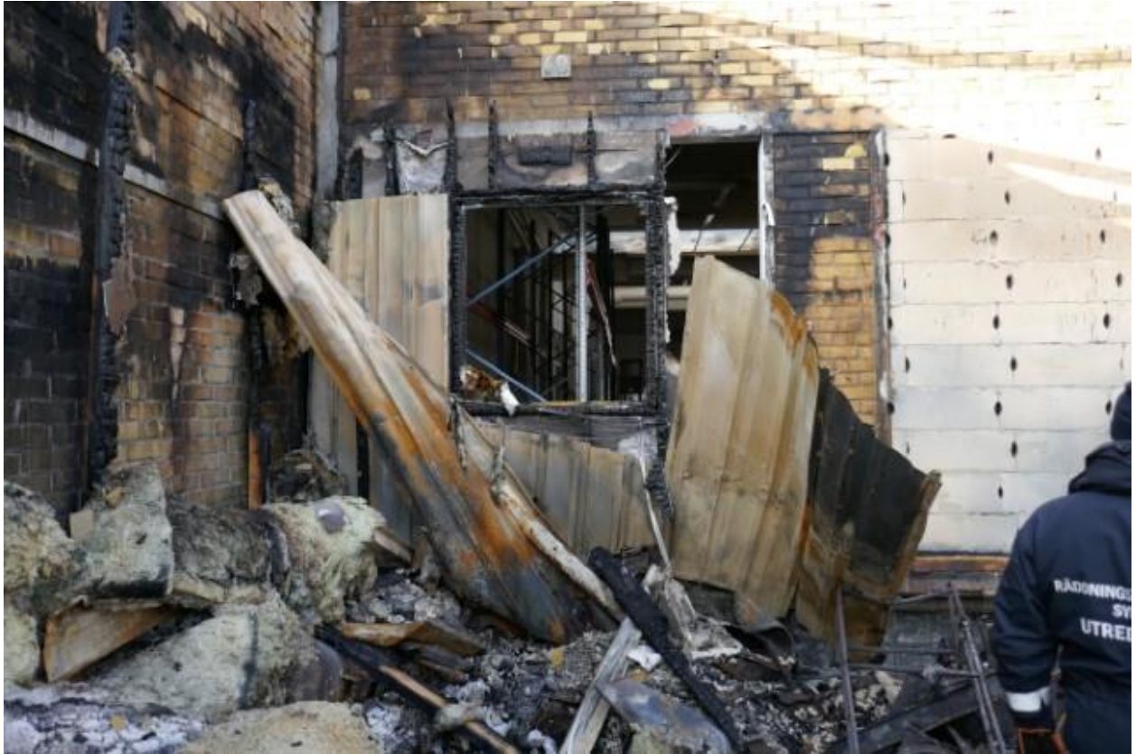
Bild 5. Brandskador på fönster till angränsande verksamhet.
