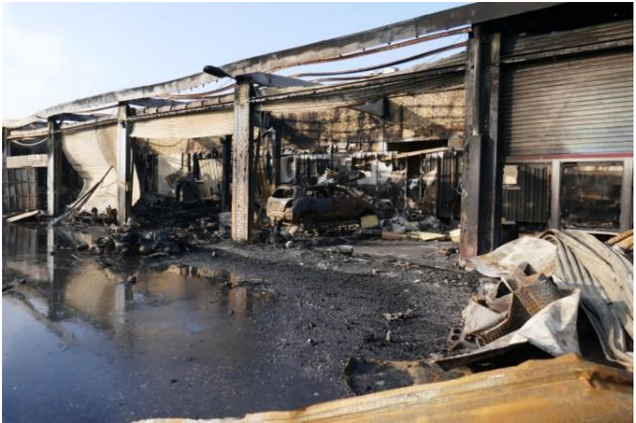
Bild 3. Kraftiga brandskador på bilverkstaden.
