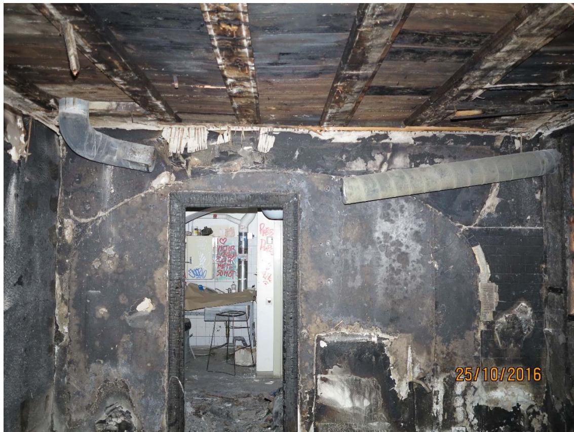
Figur 3. Bild tagen i brandrummet ut mot korridor. Bilden är tagen vid utfört platsbesök.
