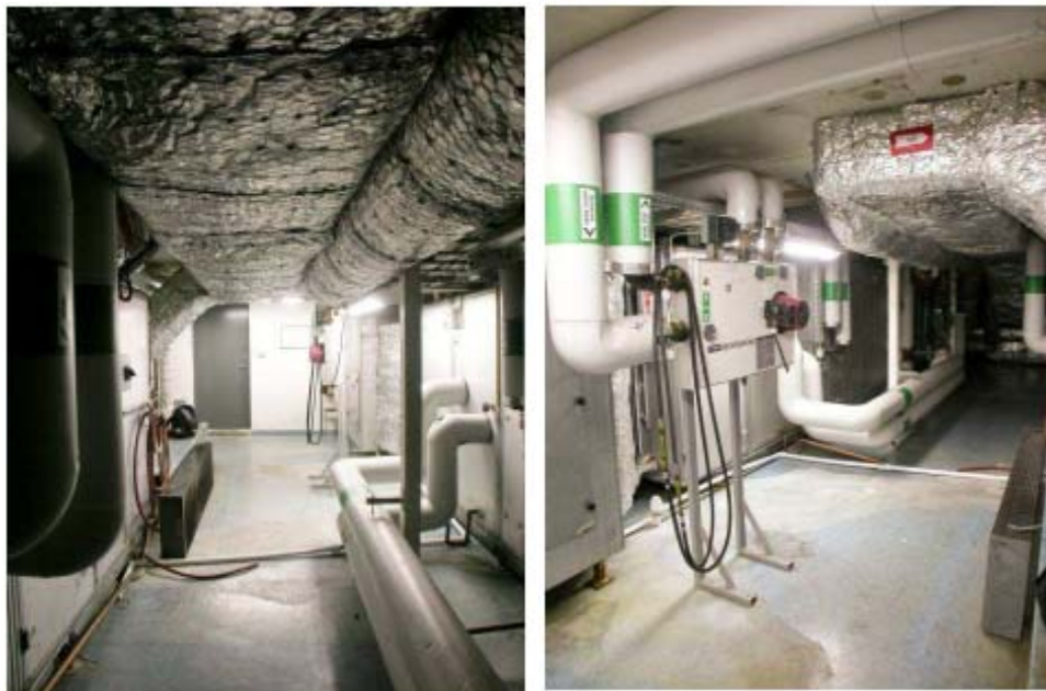
Figur 7. Fläktrum på vindsplanet före branden.
