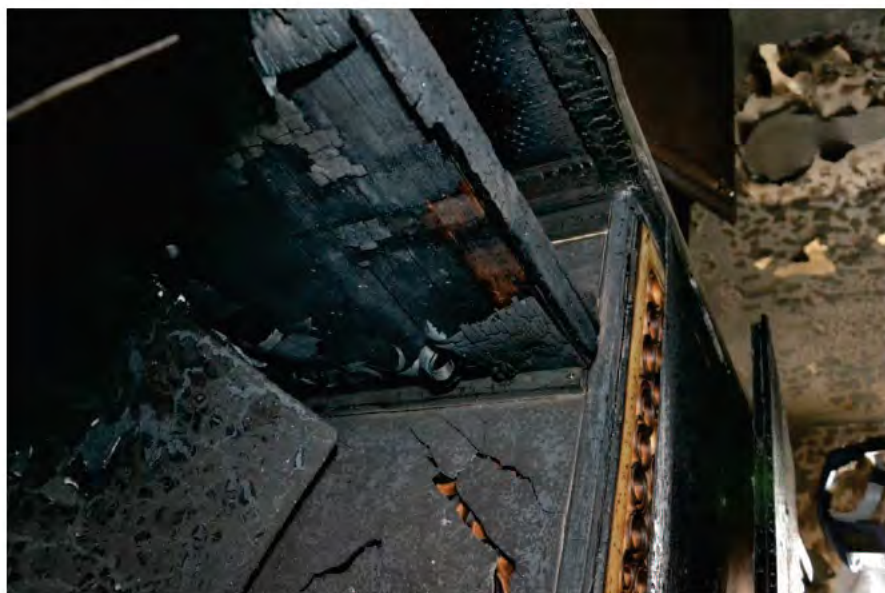
Bild: Undersidan av bänkskåp i det område som bedömts som primärbrandplats.
