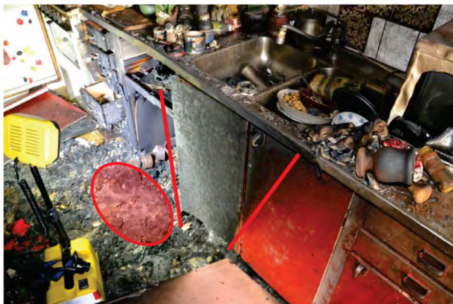
Bild: På skåpluckorna till diskhons underskåp kan formerna av ett s.k. "brand-v" skönjas (se röda streck). Tonad röd ellips motsvarar markerat område i ritning ovan.
