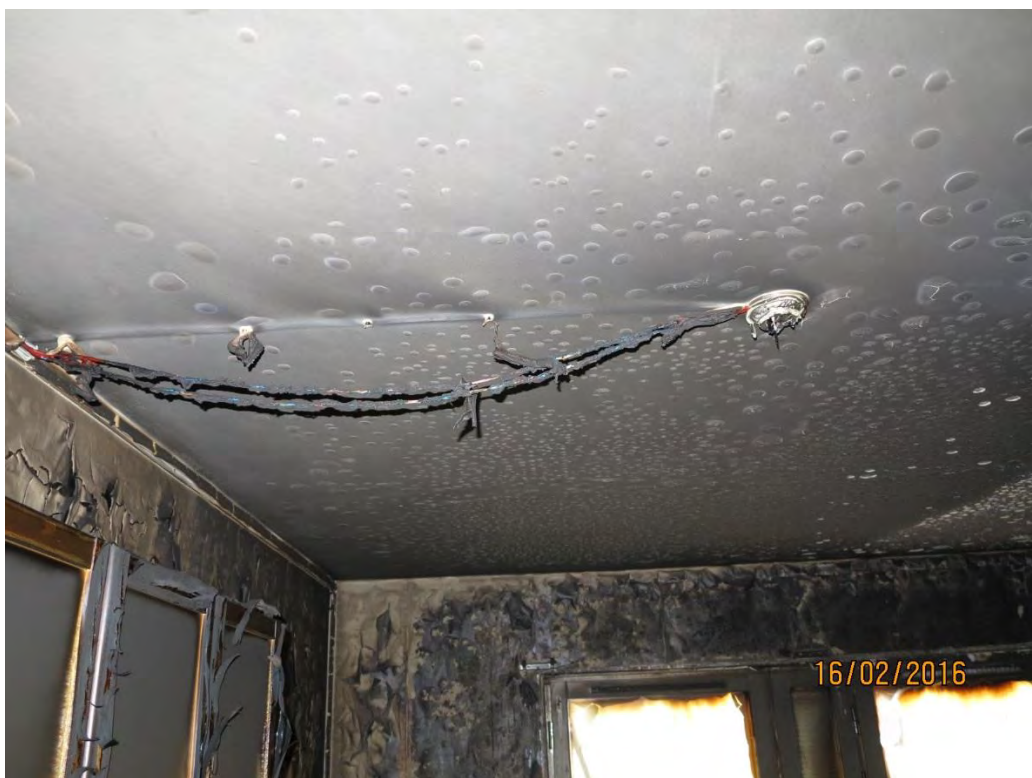
Bild 2. I taket - rökdetektor kopplad till brandlarmanläggningen. Foto: SSBF/MX.
