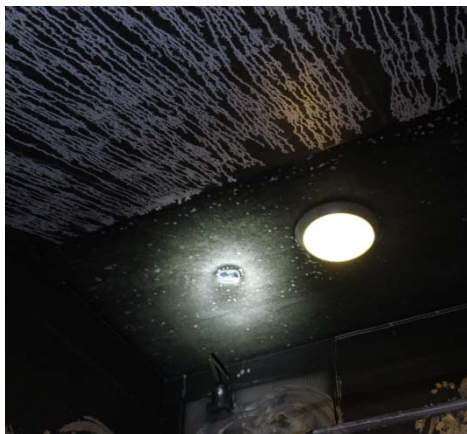
Bild 4, Brandvarnare utanför vind
