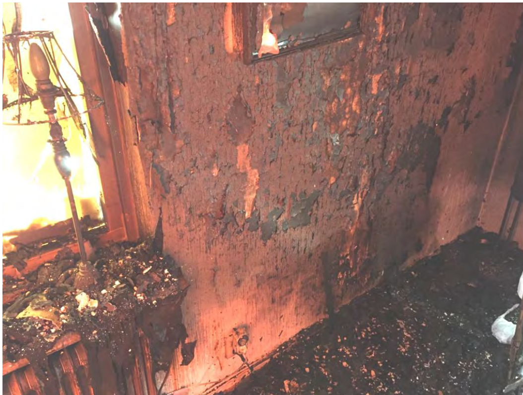
Bild 5: Rummets lägst belägna brandskador återfinns på väggen bakom soffans högra del.
