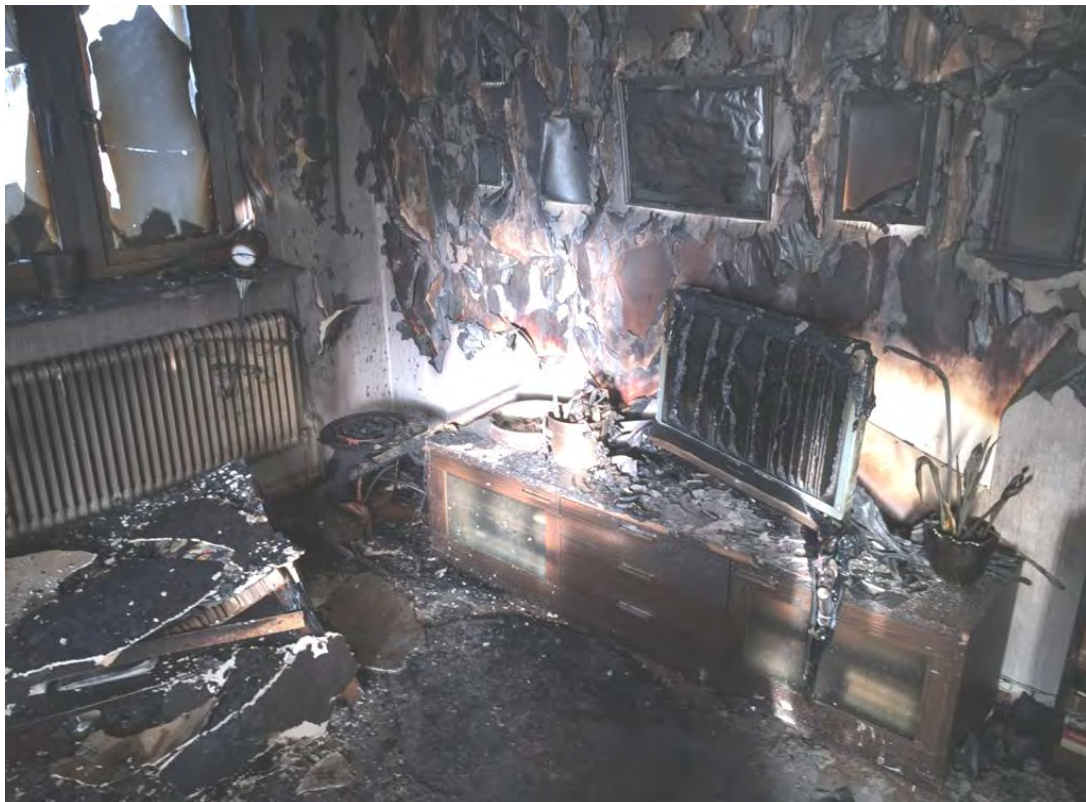
Bild 2: Värmepåverkan har skett på tv-bänk, TV och tapet.
