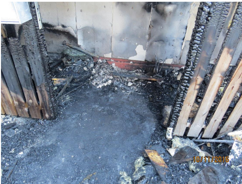
Bild 3: visar dörröppningen och de låga brandskadorna.
