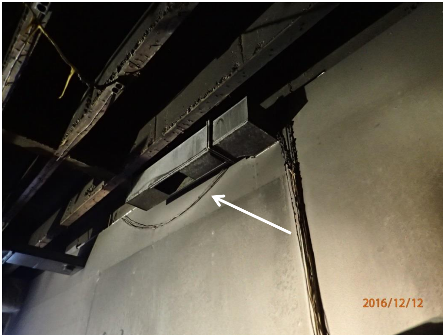
Bild 3: Vägg mot frisørsalong. Pilen visar öppen ventilationslucka
