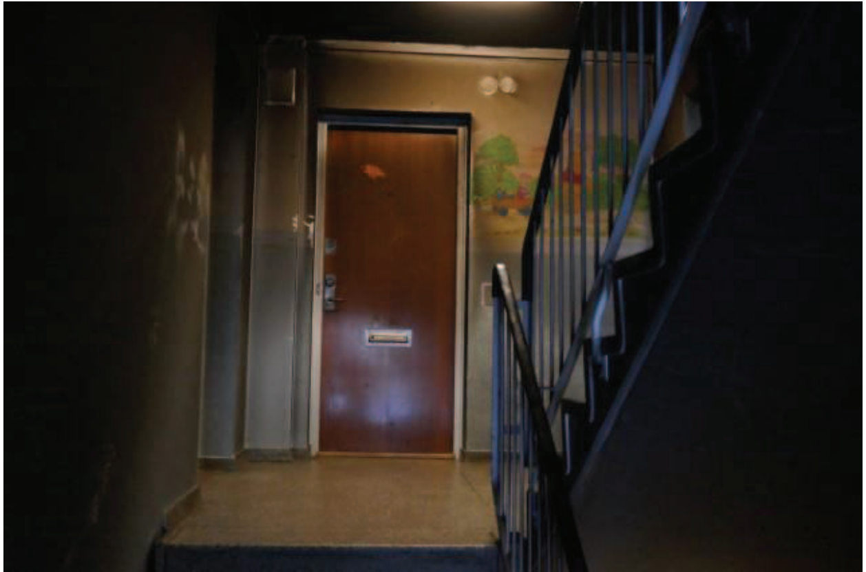
Bild 4. Sotskador på väggarna på bottenvåningen.
