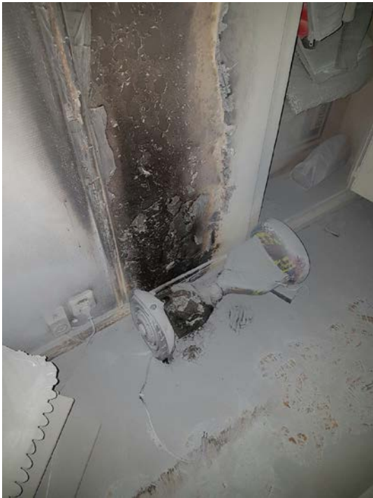
Bild 1 Brandskador på hoverboard och vägg
