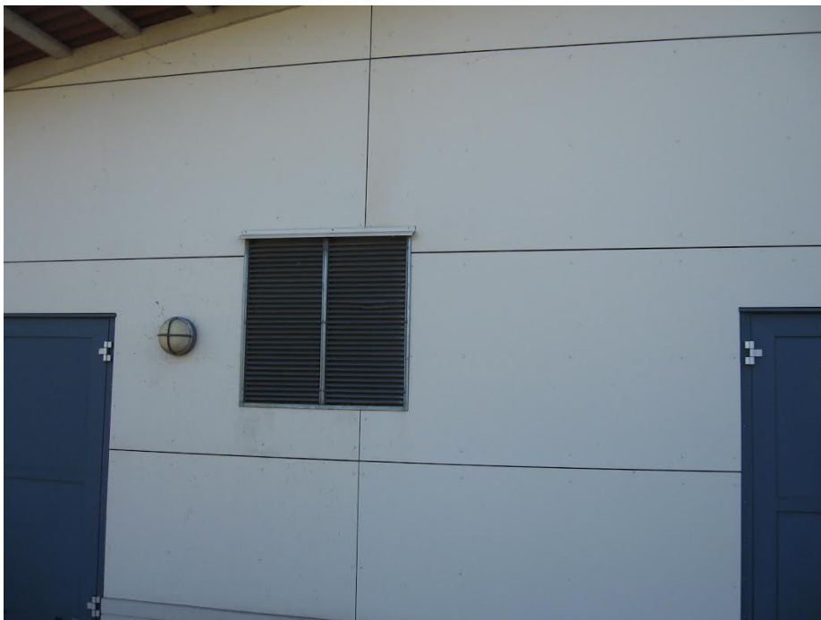
Bild 4. Friskluftsintaget till ventilationsanläggningen.
