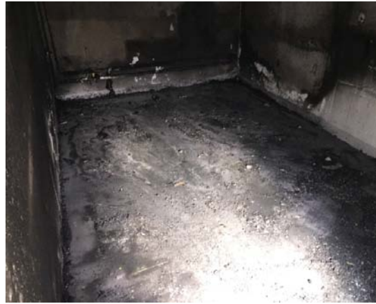
Bild 5. Utrymme där branden startat. Brandrester bortlämpades av RSG.
