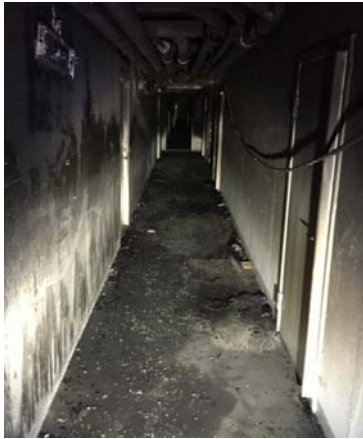
Bild 4. Källargången efter branden.
