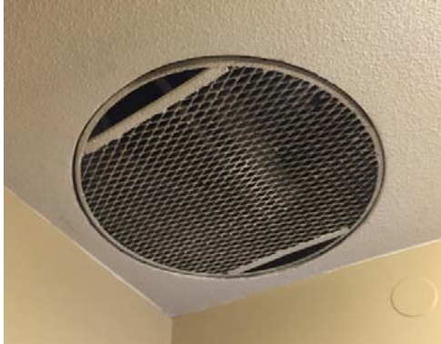
Bild 9. Röklucka i trapphus nummer 6.
