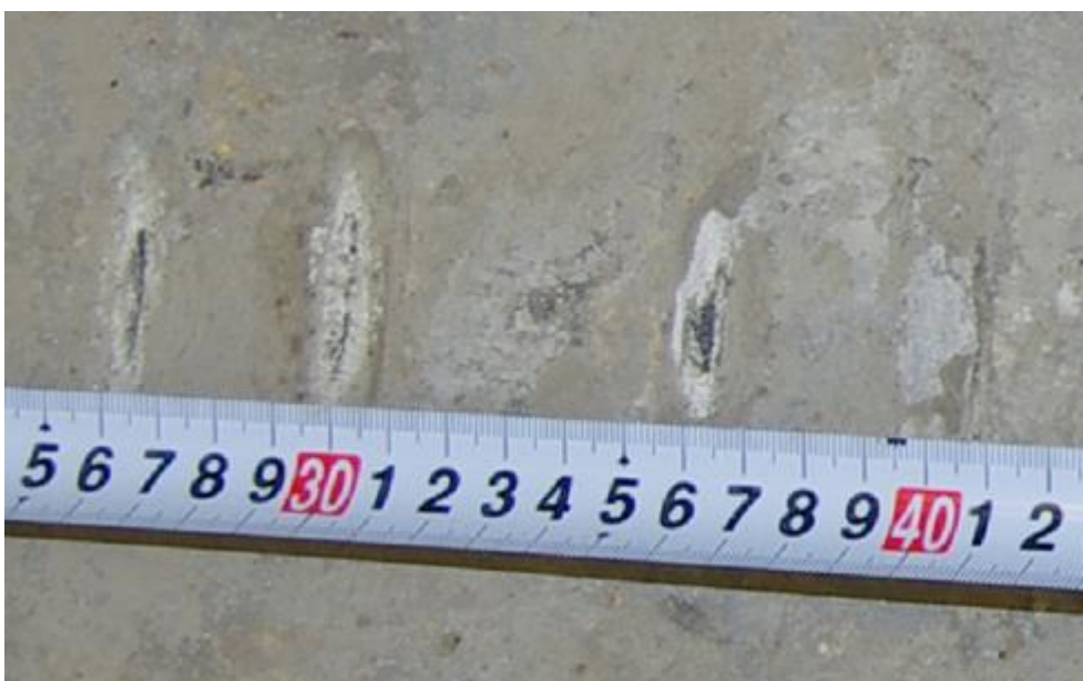
Figur 22 Detaljbild av skadorna på skyddsplåtens insida.
