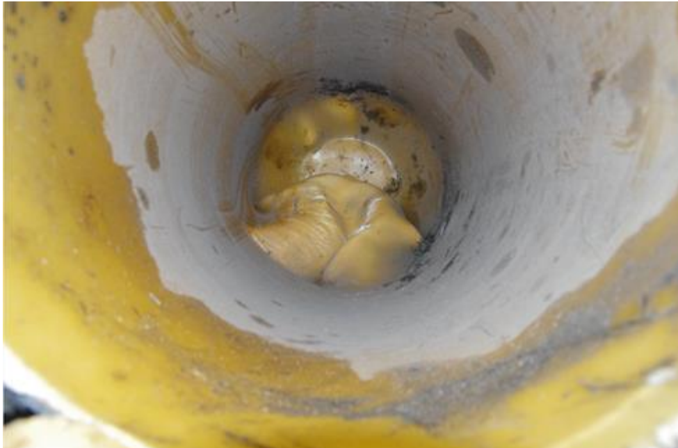
Figur 17 Tankens inre gastäta skikt uppvisar endast skador (bucklor) som sannolikt uppkommit i samband med explosionen. I övrigt är skiktet i gott skick.
