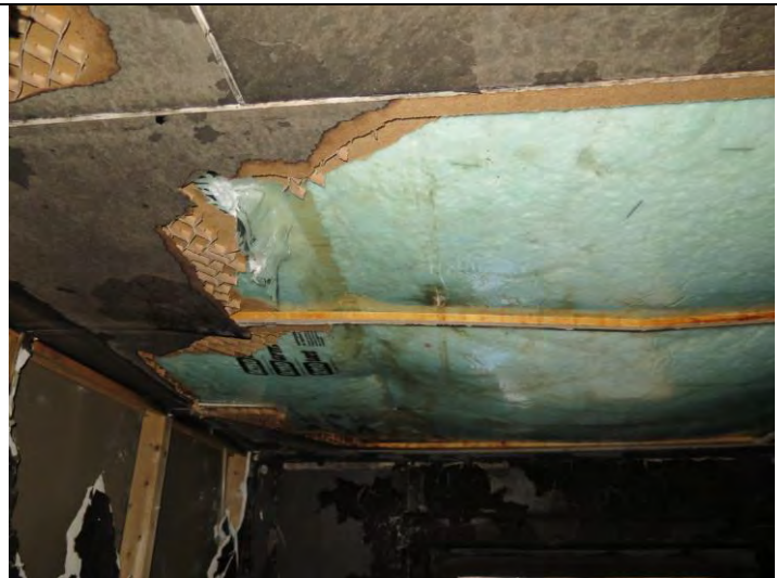
Figur 5, visar taket ovanför sängen. Här skedde enligt insatsrapport även brytning av tak för att se så att ingen spridning skett in till konstruktionen.
