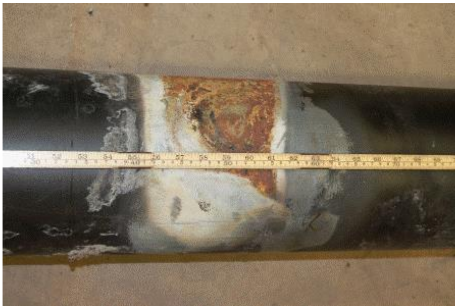
Bild 5. Här kan man tydligt se området på skorstenen som blivit överhettad på grund av att skorstenen inte fått någon avkylningsseffekt då vindsisolering legat mot röret.
