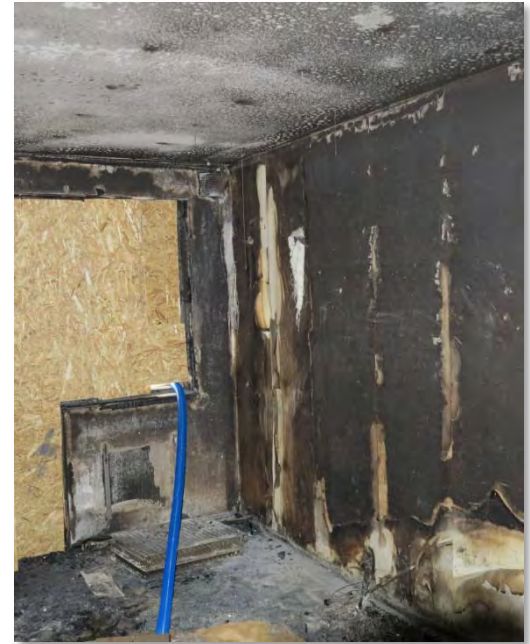
Bild 6 Vy mot fönster där Polisen misstänker att branden startade
