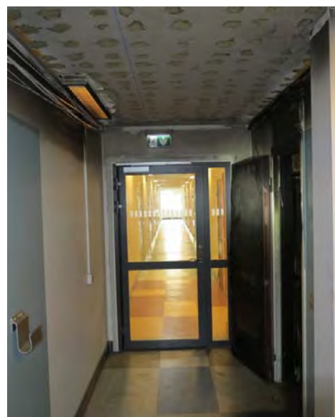
Bild 5 Korridor utanför branddrabbad lägenhet
