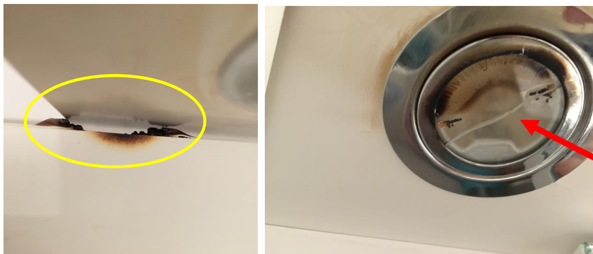
Bild 3 och 4. gula ringen visar värmeskadorna på ovensidan av skåpluckan och röda pilen visar den med glaset spräckta och värmepåverkade spotlighten.
