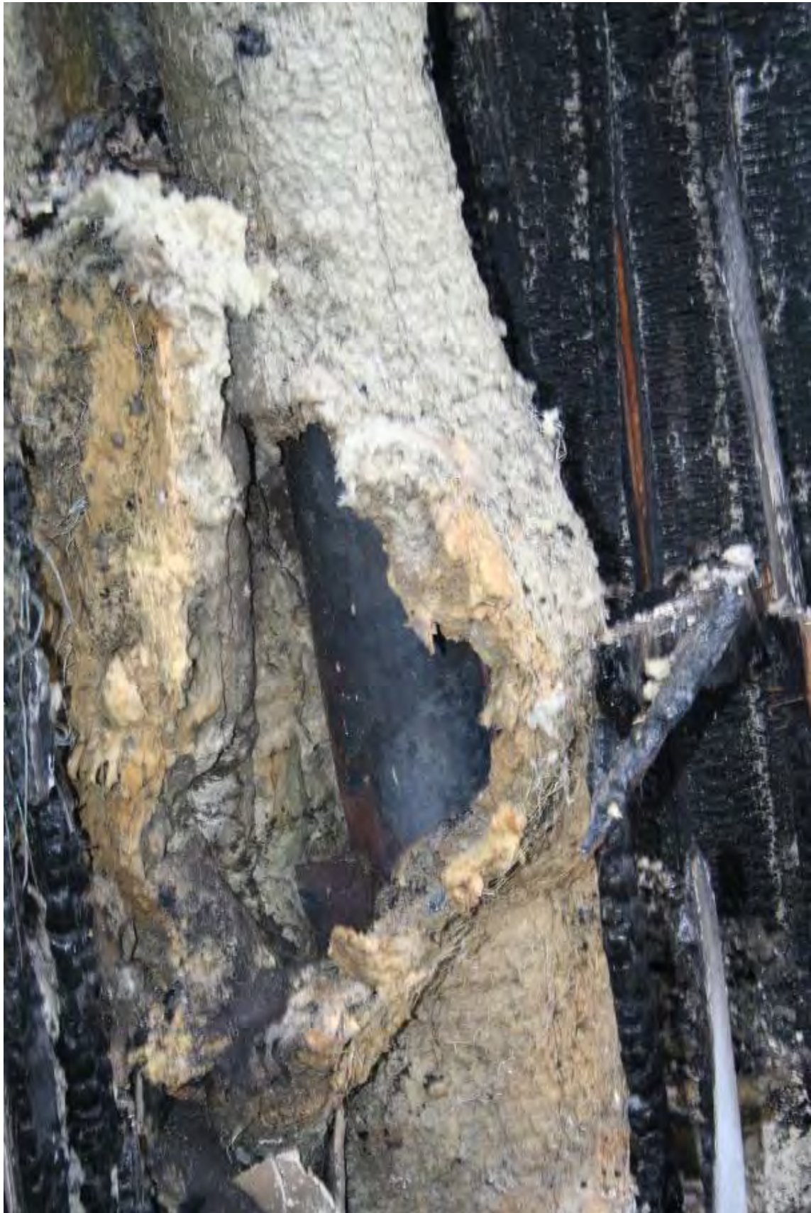
Bild 11. Efter friläggning ses rökrörets värmeskador.
