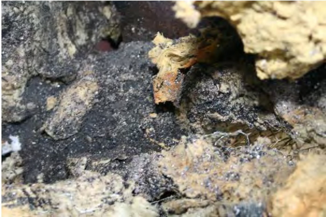
Bild 9. Sot mellan skorsten och isolering.
