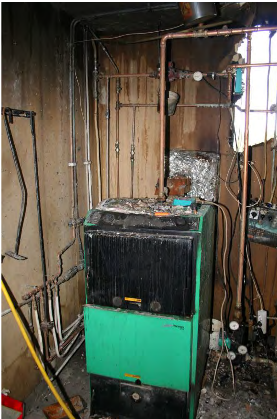
Bild 8. Pannrum med vedpannan.
