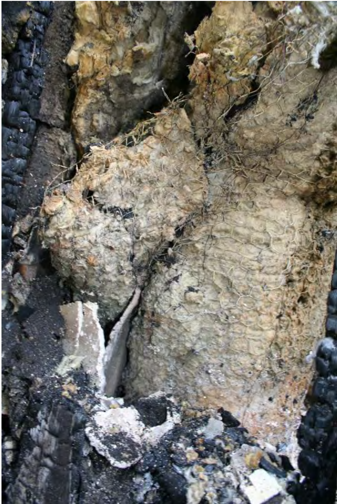
Bild 10. Den bristfälliga isoleringen runt stålröret.
