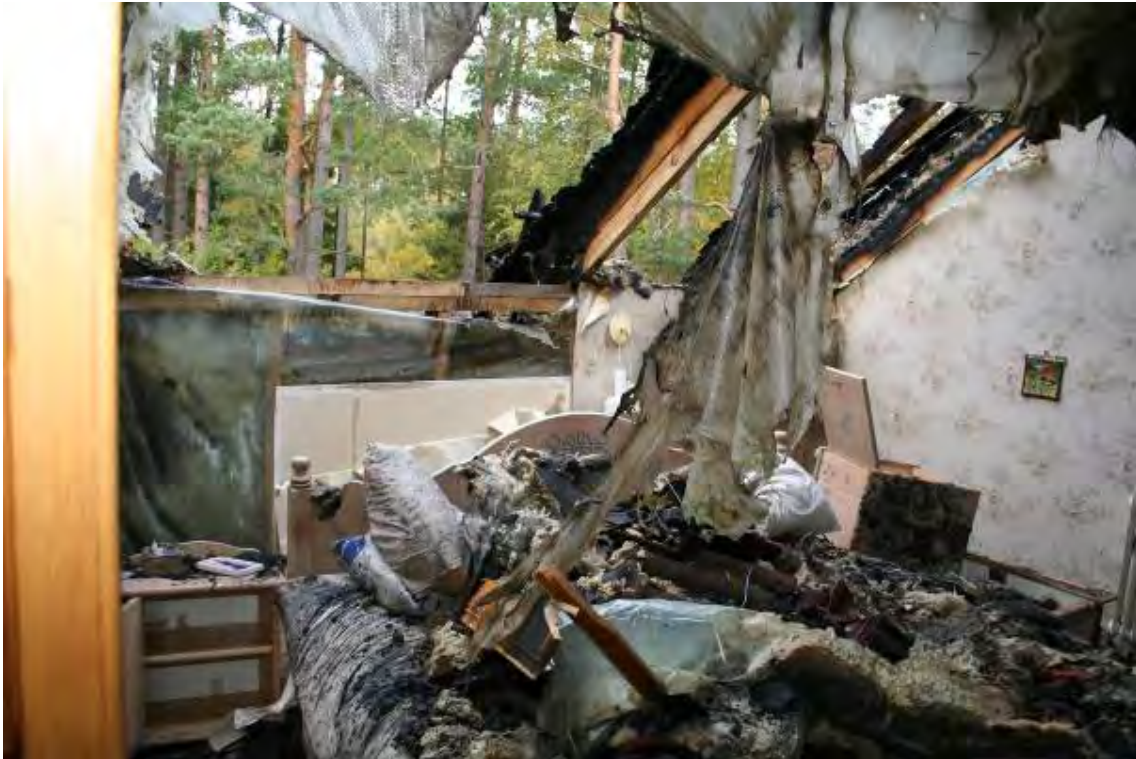
Bild 6. Vidare brandspridning från takfot upp till vind.
