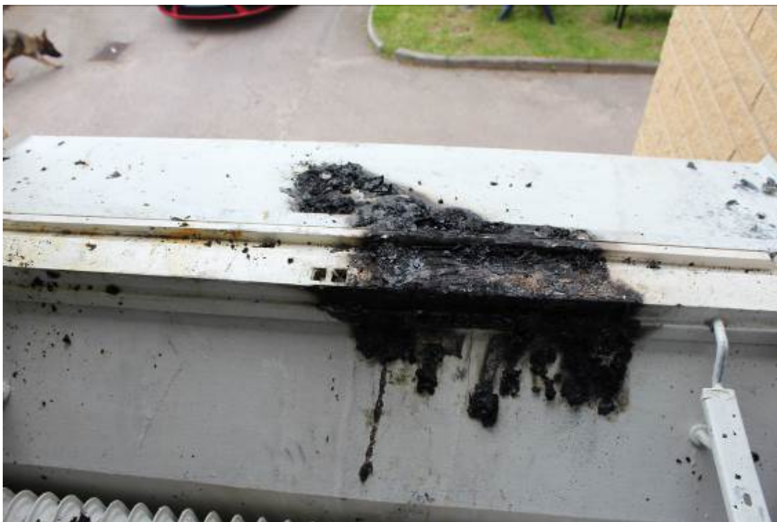
Bild 4. Något liknande plastmaterial som har smält vid fönsterkarmen.
