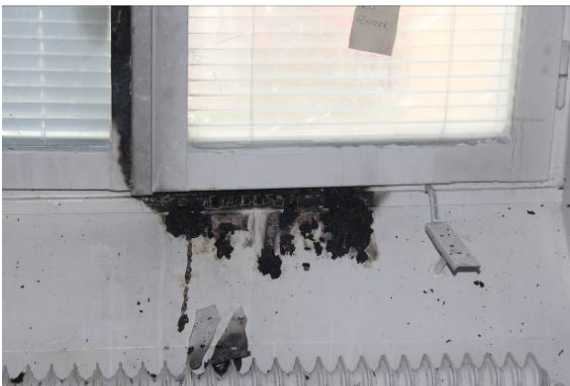
Bild 5. Högerfönstret har stått uppställt och det vänstra har varit stängt vid inkastningstillfället av det brandbara materialet.
