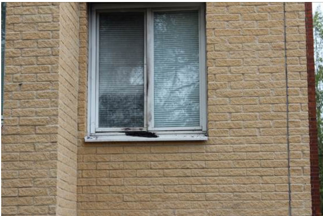
Bild 1. Man ser brandrester på fönsterbläcket, där någonting har kastats mot fönsteröppningen.
