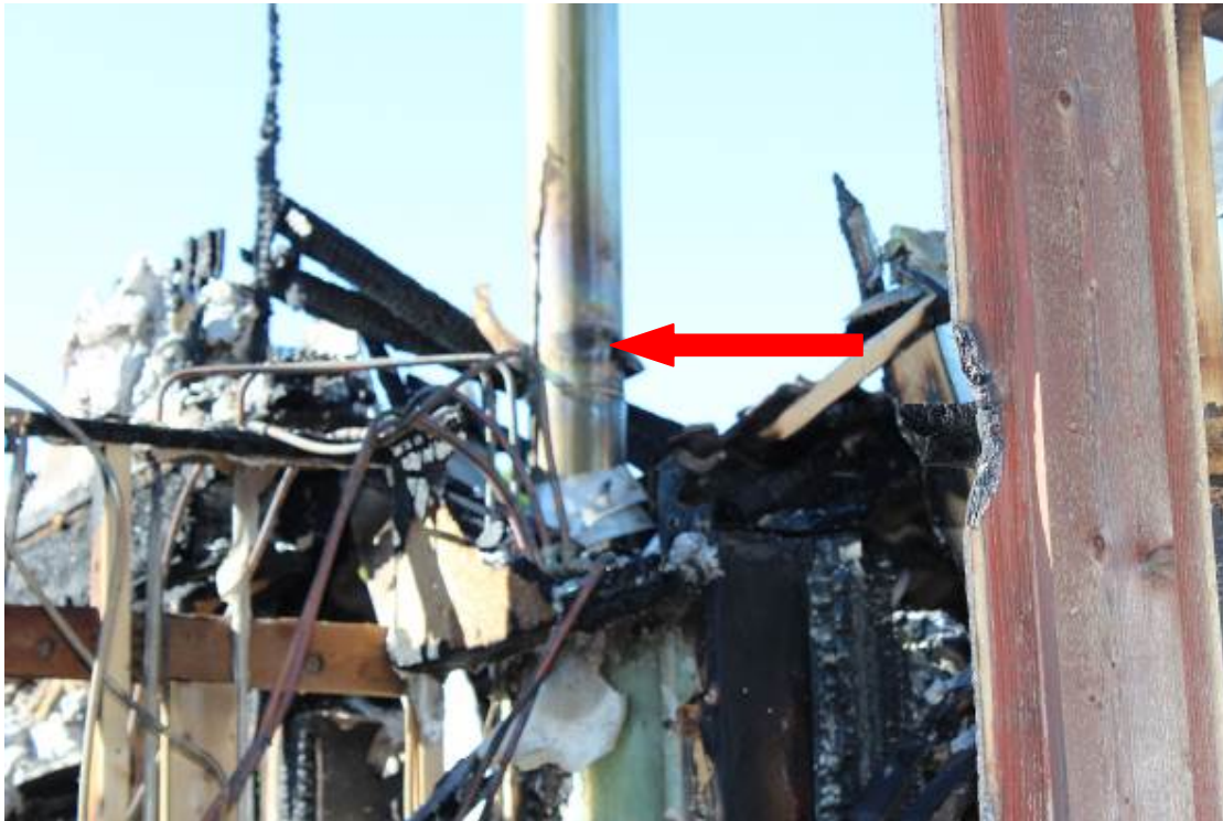
Bild 5. Röret har haft en kraftig värmepåverkan just vid genomförningen i taket mellan pannrummet och vindsvåningen.
