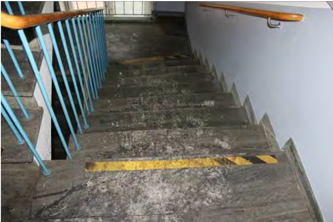
Bild 2. Trappstegen är täckta av sot från den feta röken i hela trapphuset.
