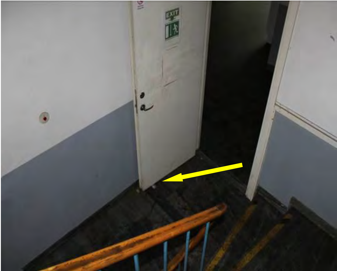
Bild 1. Brandcellsörr uppställd med plastkil vid samtliga våningsplan.
