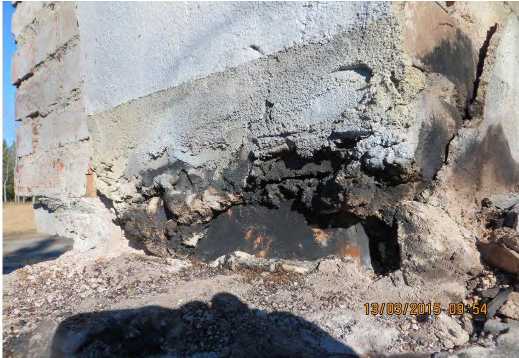
Bränd plats på skorstenen ovan den öppna spisen. Bjälklagets placering mellan första och andra våningen.
