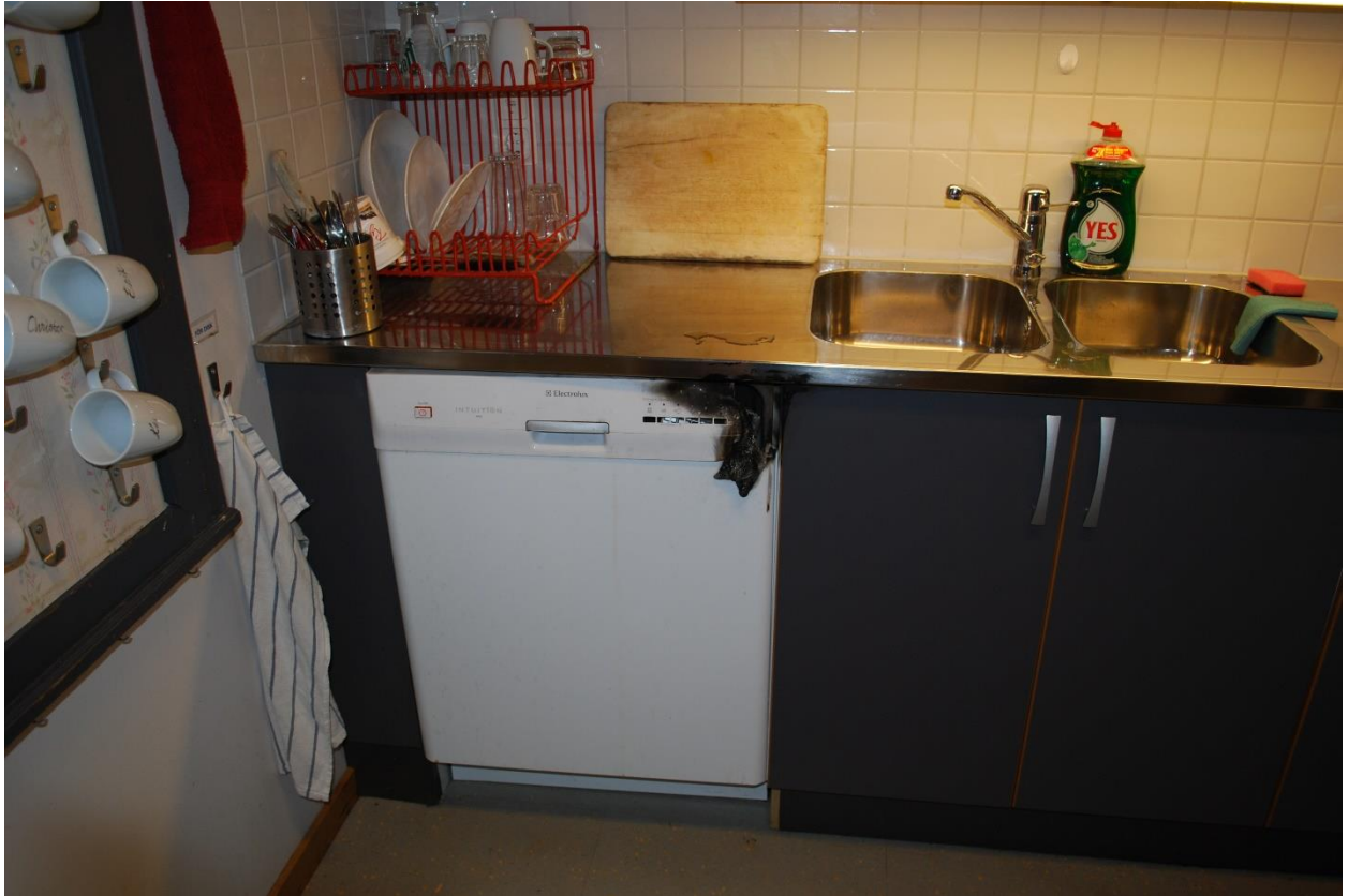
Foto 1, diskmaskinen med brandskada
