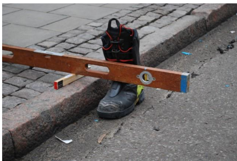
Nivåskillnad vid gata och trottoar
