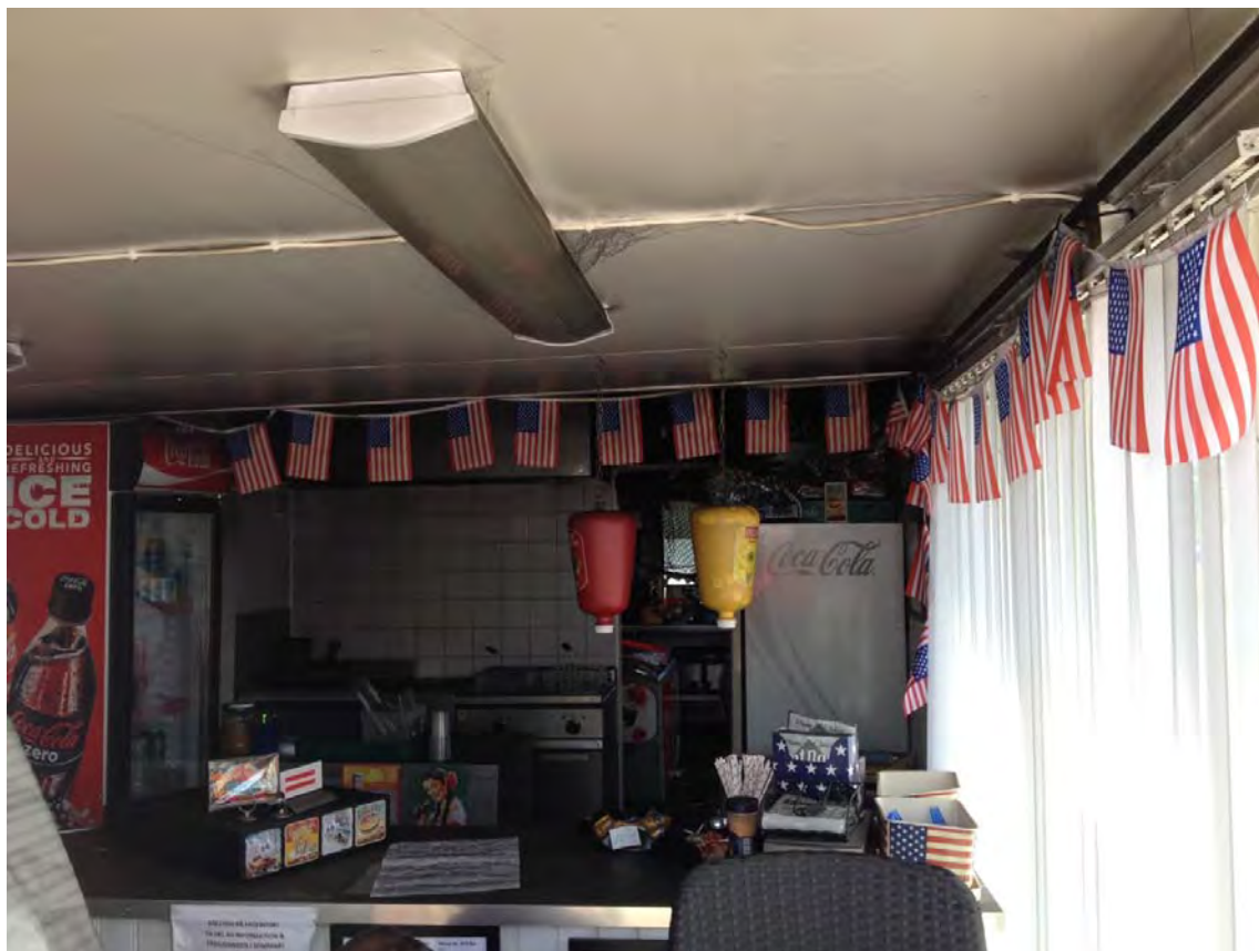
Bild 5. Rökskador i resterande del av gatuköket.
