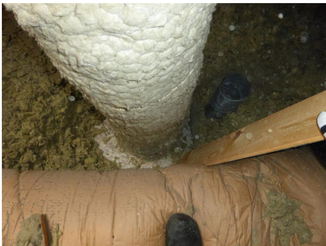
Figur 11 Imkanalen är försedd med obrännbar isolering och är tätad mot vindsbjälklaget
