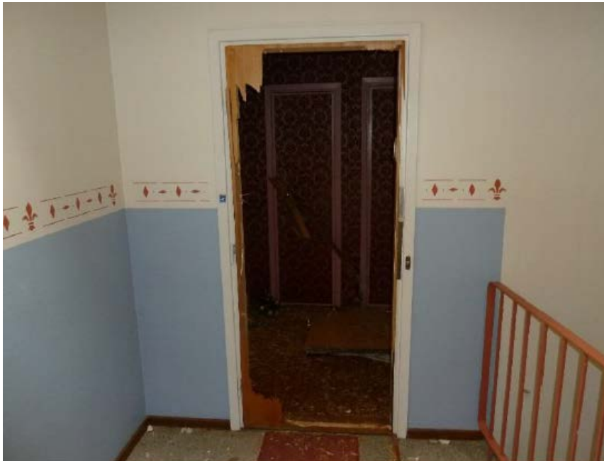
Bild 10. Lägenhetsdörr Trädgårdsgatan 12. Foto: Byggkonsult KNSS AB
