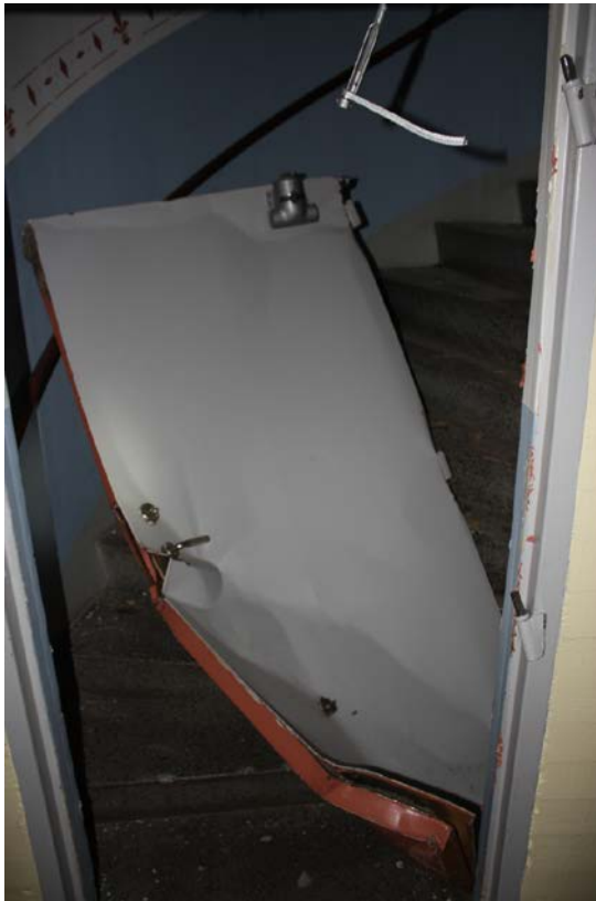
Bild 7. Skadad dörr mellan källargång och trapphus. Foto: MSB
