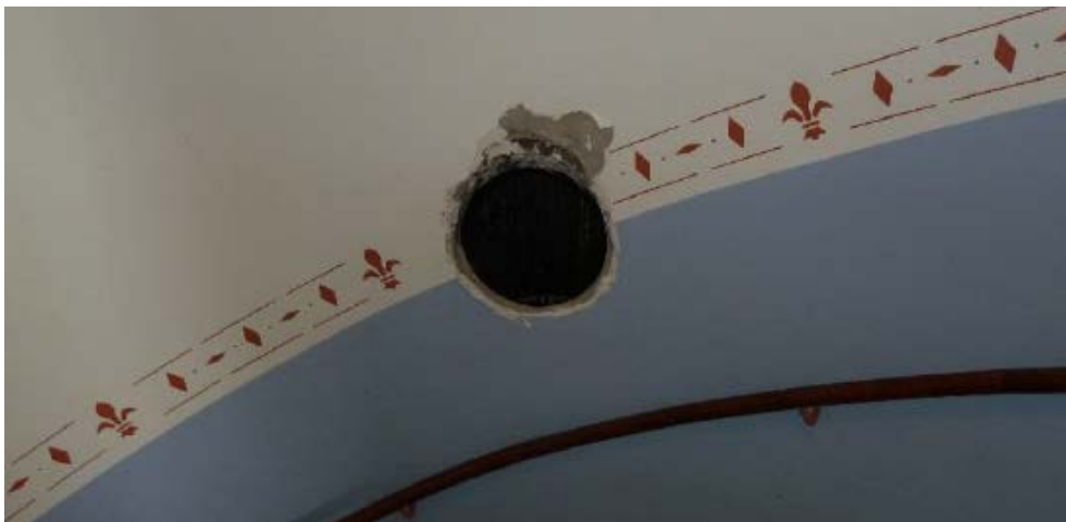
Bild 9. Trapphus Herrgårdsgatan 19. Sopnedkast där lucka och ram är utbläst. Foto: Byggkonsult KNSS AB
