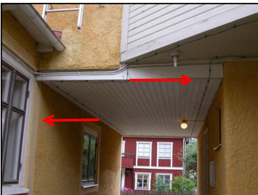
Figur 30: Portlider försett med värmedetekterande kabel vid pilarna.
