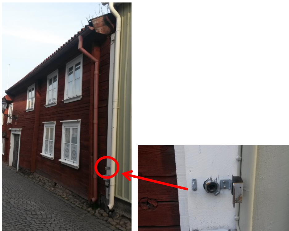
Figur 33 och figur 34: Uttag för att trycksätta sprinklern på en av Gamla stans vindar, vinden på det röda huset. Foto: Anna Henningsson
