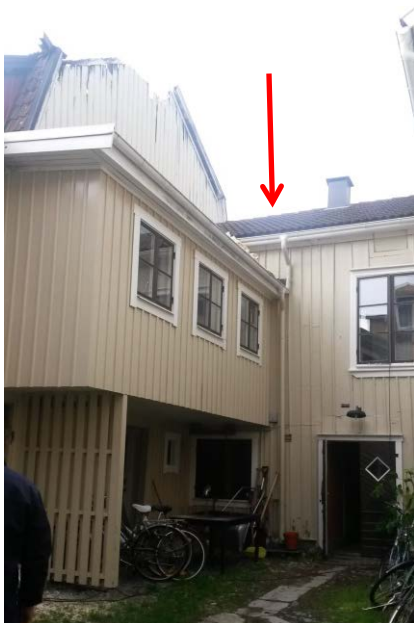
Figur 38: Taket från vilket personal arbetade utan säkerhetsseklar fram tills eftermiddagen.
