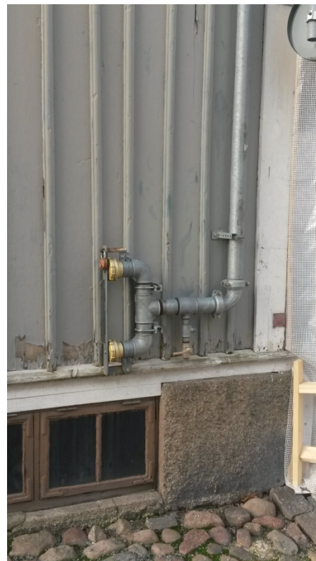
Figur 11: Anslutning till fasadsprinklern på Vaxblekaregränd. Foto: Anna Henningsson
