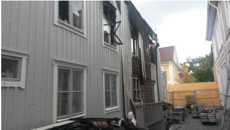
Figur 15: Vaxblekaregränd. Lågor slog ut från ett fönster i bortre delen av lägenheten på andra våningen till vänster i bild. Fasaden där fasadsprinklern användes syns till höger i bild.
