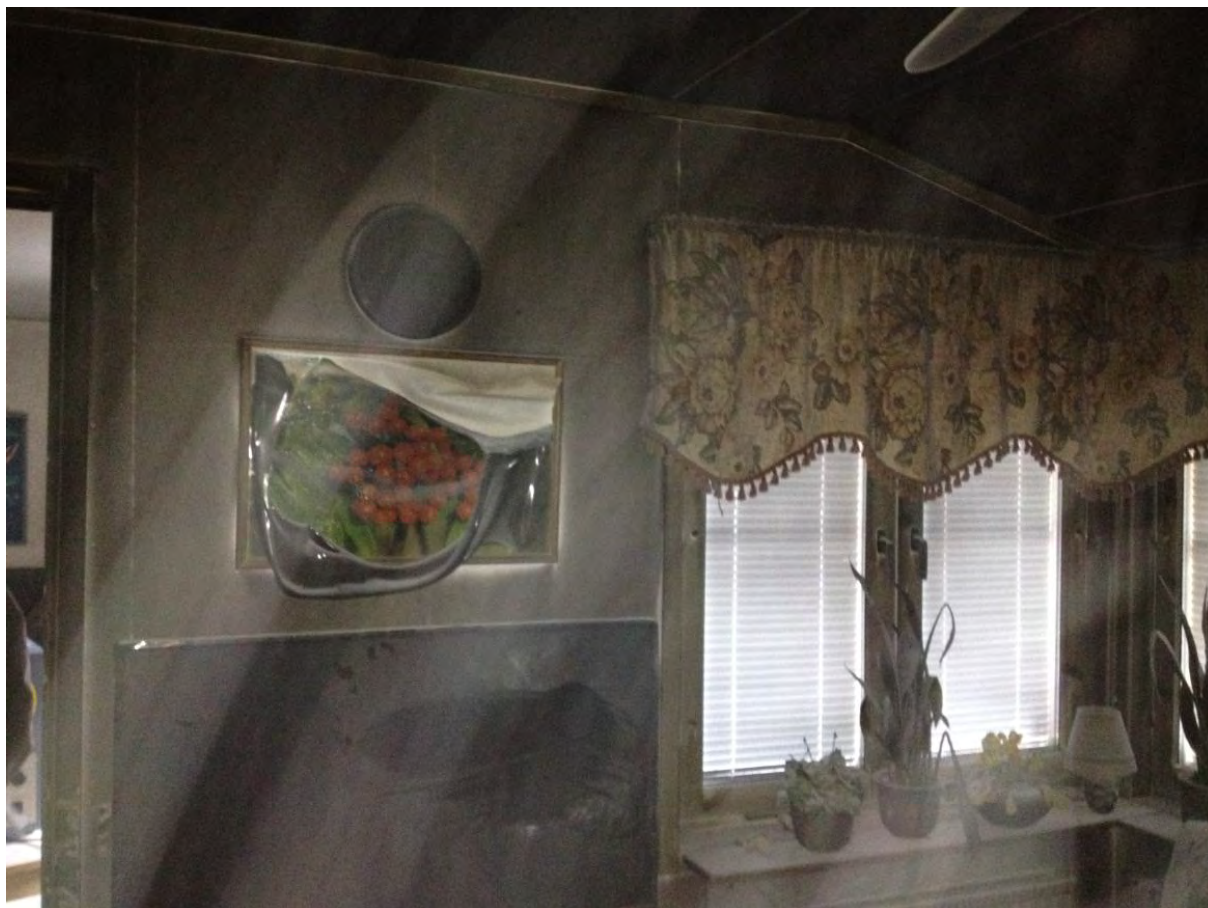
Figur 7: Smält plastglas framför tavla. Samtidigt kan noteras att temperaturen i rummet inte varit tillräckligt hög för att antända gardinen i rummet.
