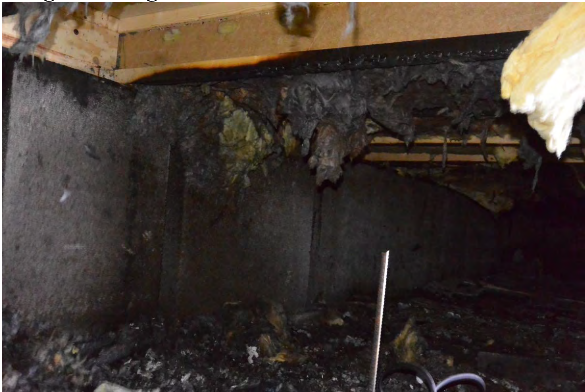
Bild 4. Platsen där avfuktaren var placerad. Skadorna i golvbjälklaget är som mest omfattande här. Hjärtmuren är som mest brandpåverkad bakom avfuktarens placering.
