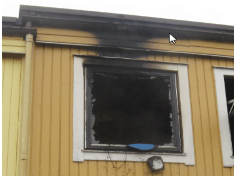
Bild 6. Konstruktionen på takfoten gjorde att brandgaser inte lika lätt kunde komma in i den osekionerade vinden
