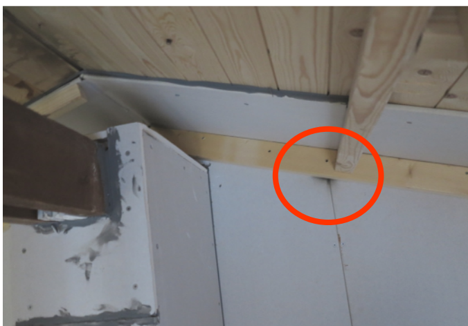
Bild 5. Ringen markerar ett visst läckage av brandgaser i skarven mellan tak och vägg.
