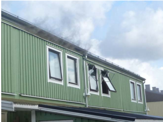
Bild 3. Ankomstbild: brandgaser läcker ut vid takfoten från aktuell lägenhet/vind.
