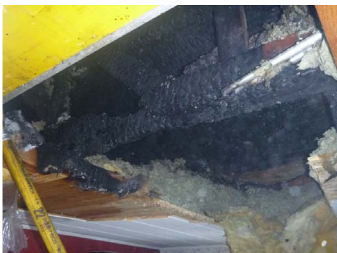
Bild 4. Kraftigt påverkat vindsutrymme, sett från övervåning.
