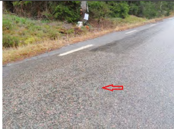
Vid pilen finns en skada i vägbanan som bedöms att ha uppkommit vid kollisionsögonblicket. Trafikverkets foto.
