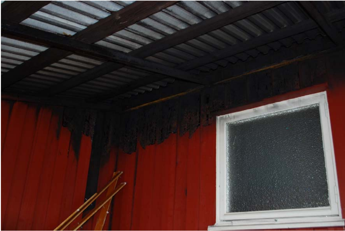
Spridning längs fasaden på 6d. Framsida och badrumsfönster.
