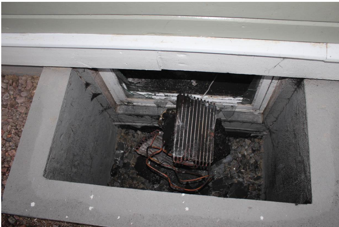
Bild 2. Här ses avfuktaren utifrån, den har lämpats ut av rökdykarna.
