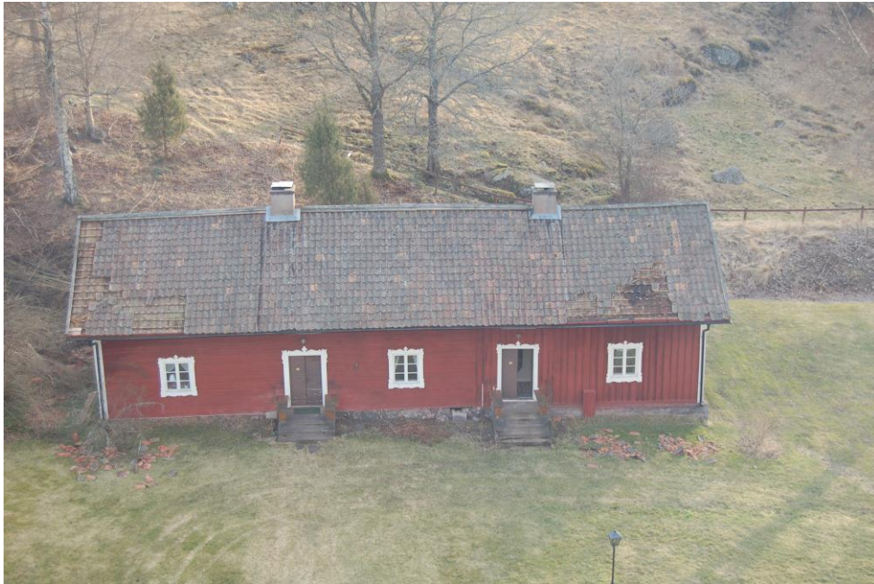
Ovan. Brunnshuset (byggnad 4) med endast små skador på taket.
