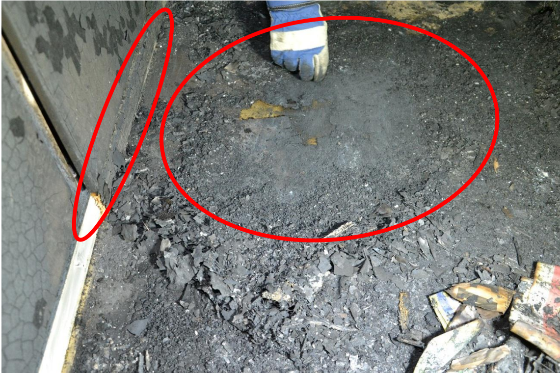
Hallgolvet. Notera lågt belägna brandskador på hallgolv och golvlister (röd markering). Provtagning gjordes för analys på SKL.
