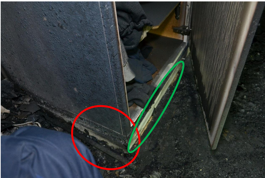
Garderoben i hallen. Notera golvlisternas brandskador vid röd markering (grön markering visar list som brutits loss vid utredningen för provtagning).
