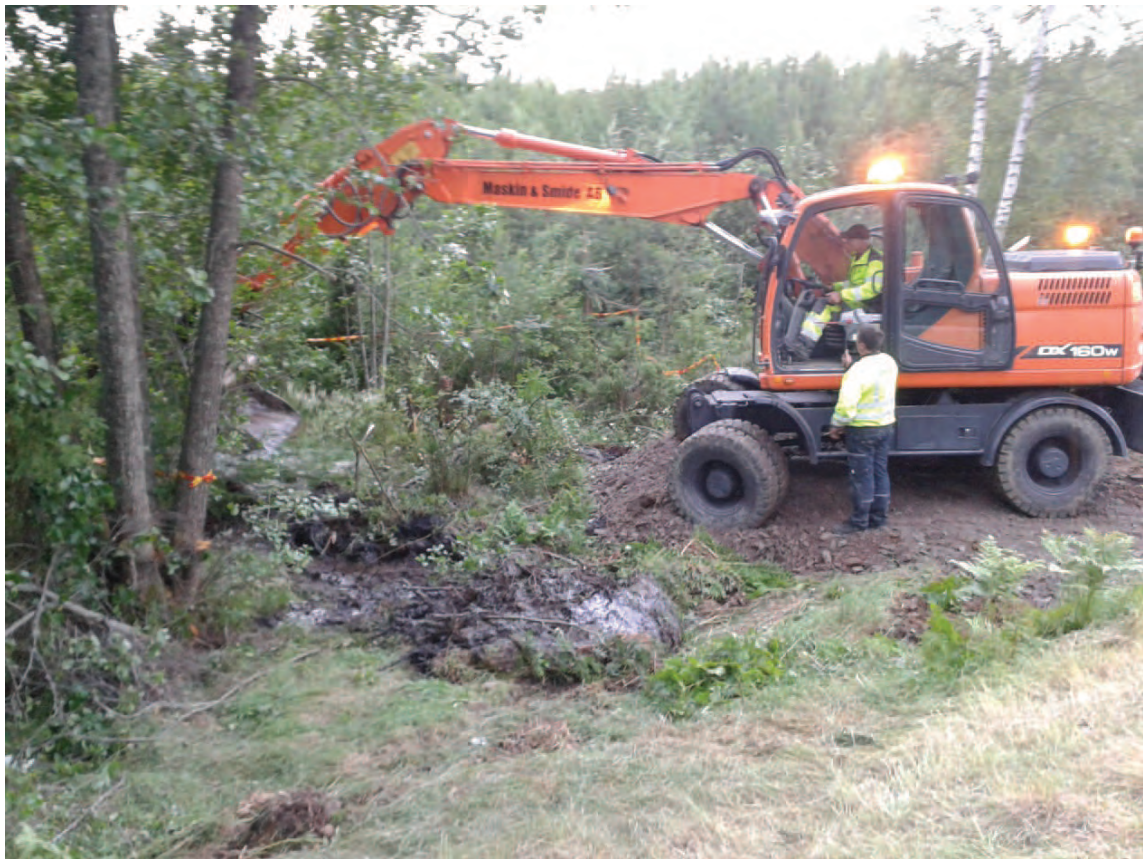
Snett framför grävmaskinens vänstra framhjul var lastbilens tank när lastbilens stannade i diket och den största mängden diesel läckte ut.
