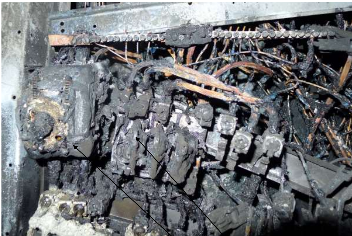
Bild 8. Komponenter på 5:e skenan nerifrån, kontaktor, överspänningskydd och jordfelsbrytare.
