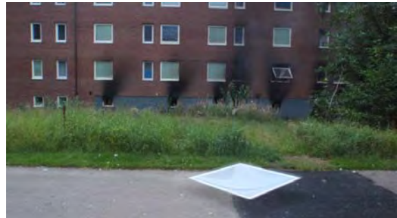
Bild 4. Bild på rökluckan som flög iväg av explosionen.
