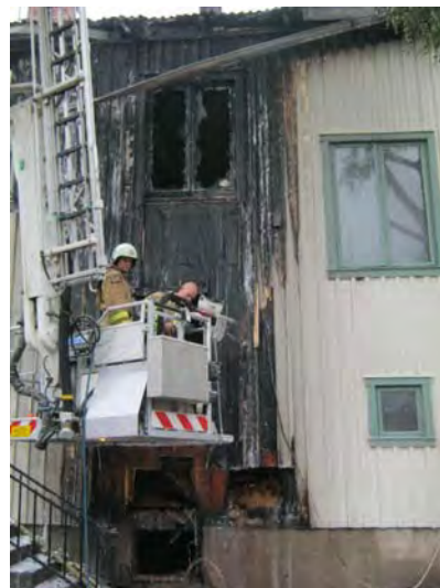
Bild 5. Fasaden där branden startade.
