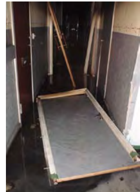
Bild 9. Dörrar som förstörts av explosionen.
