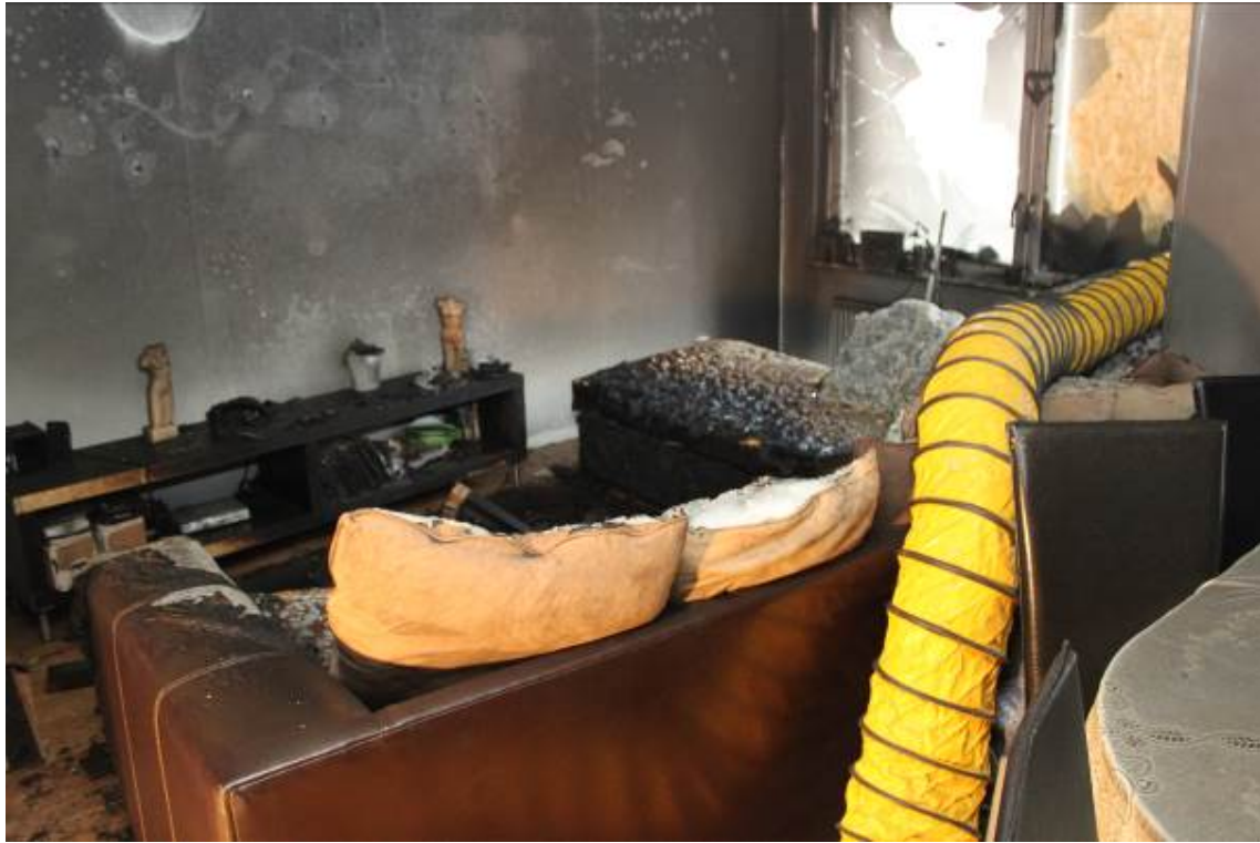
Bild 1. Hela lägenheten var rök och sotskadad.
