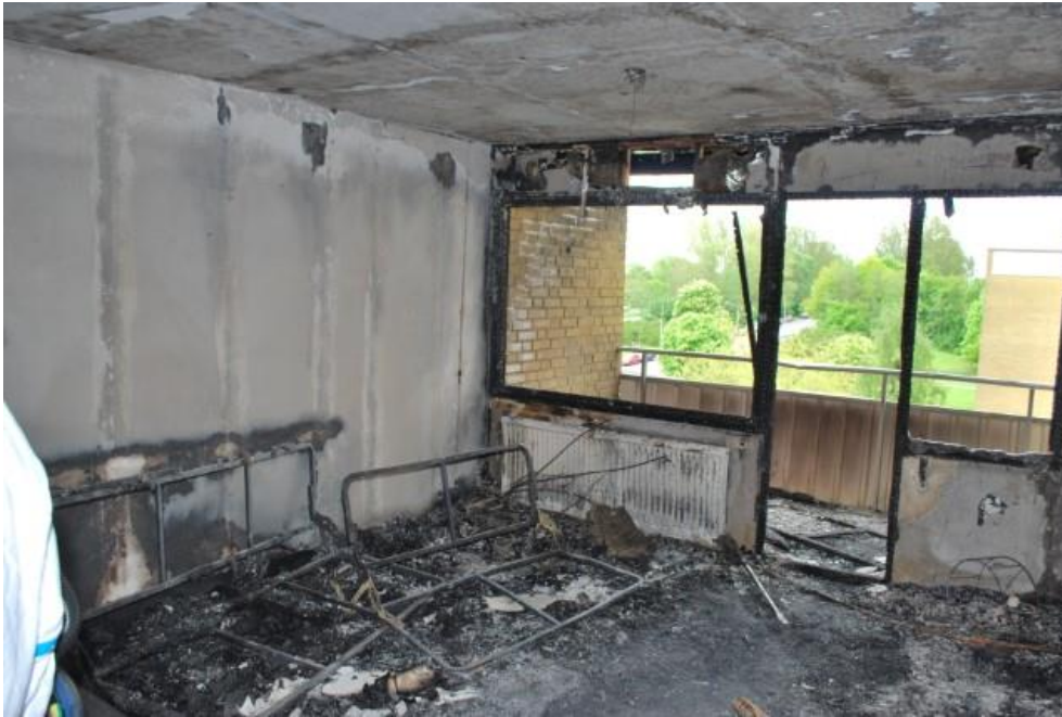
Bild 3. Del av vardagsrummet där det har brunnit som mest.
