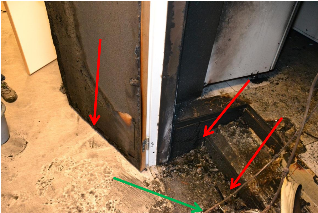
Bild: Röda pilar visar brandskador i dörr, golv och trappsteg. Grön pil visar var aggregatet låg vid framkomst (mot dörren som var stängd).
