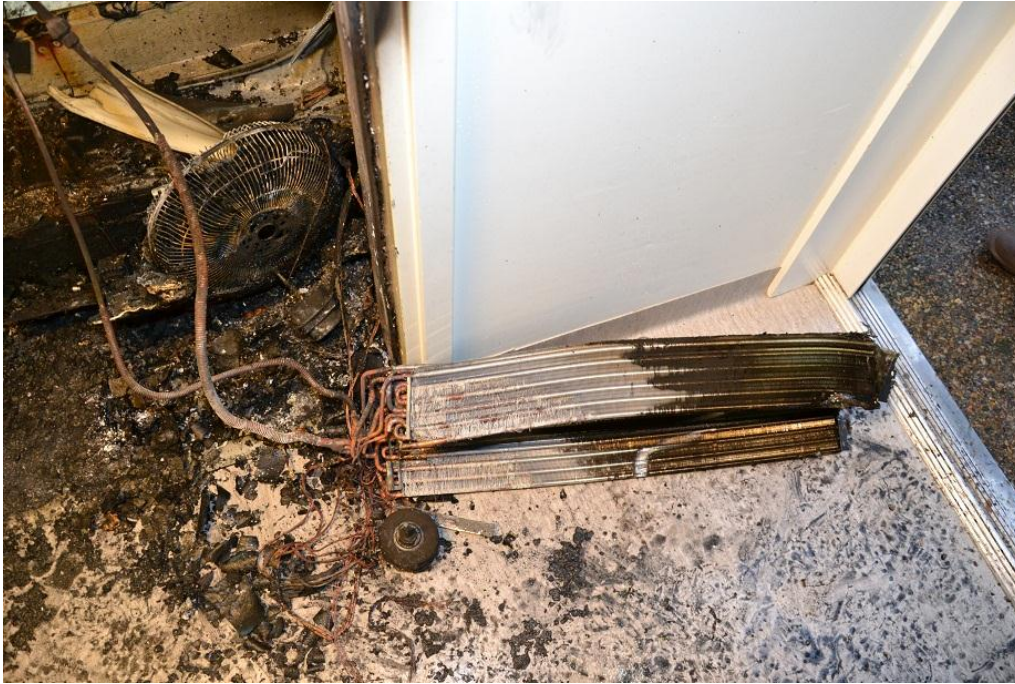
Bild: Kraftigt bränt aggregat till kylanläggning.
