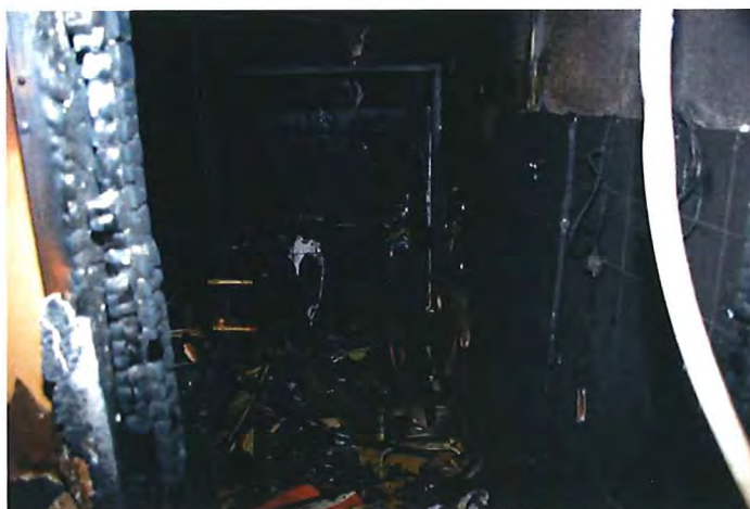
Figur 2, Badrummet som var kraftigt sotskadat
