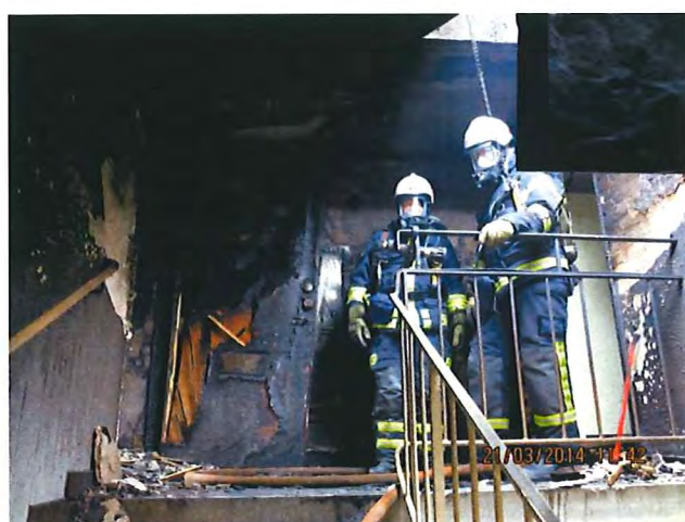
Figur 13, Trapphuset som brandskadades svårt, dörr till vänster och höger
