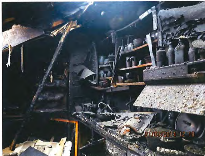
Figur 1, Sotskador i köket
