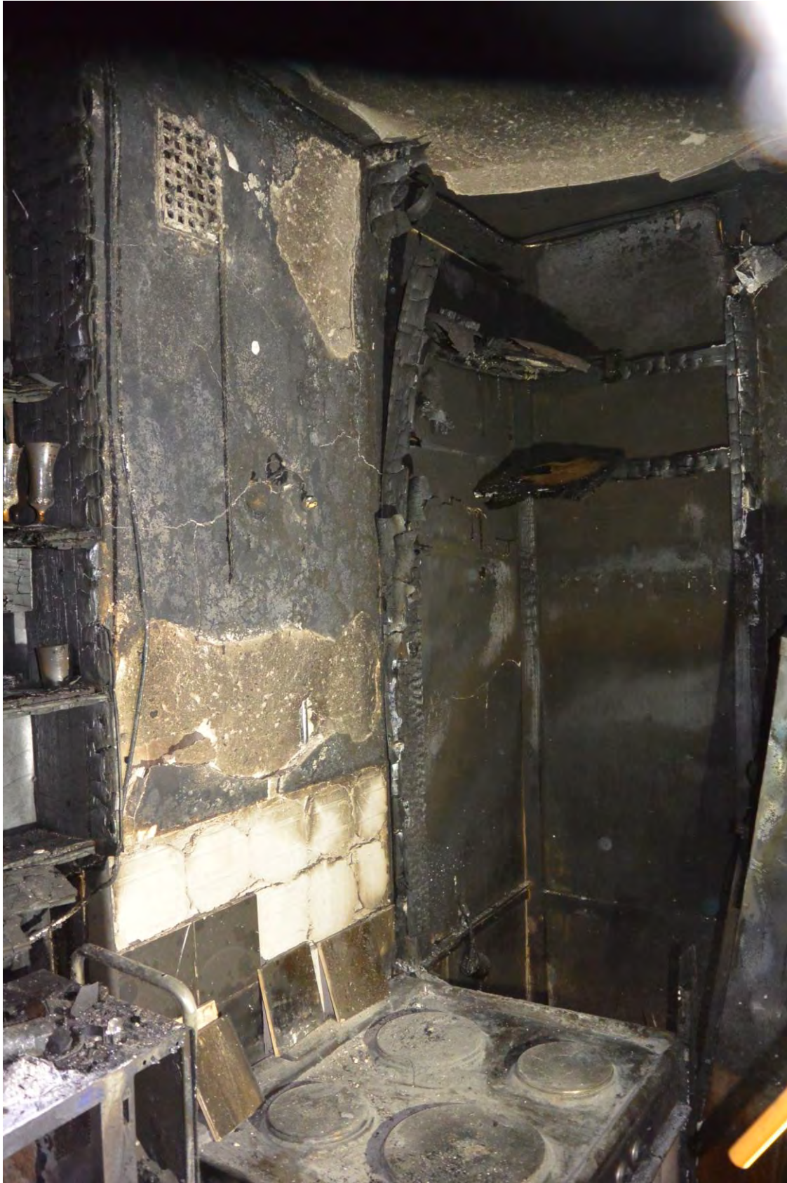
Figur 4. Spisen och de djup brandskadorna på väggen och i taket.
