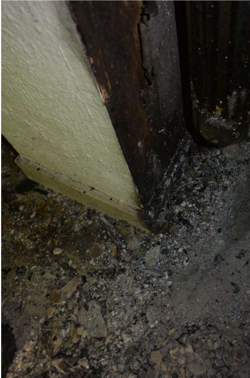
Figur 7. Detaljfotografi som tydligt visar den skarpa gränsen för brandskador vid passagen till vardagsrummet. Den kraftigt brända sidan vetter mot hallen. Listen har brunnit en längre tid i hallen, men är näst intill oskadad i passagen.
