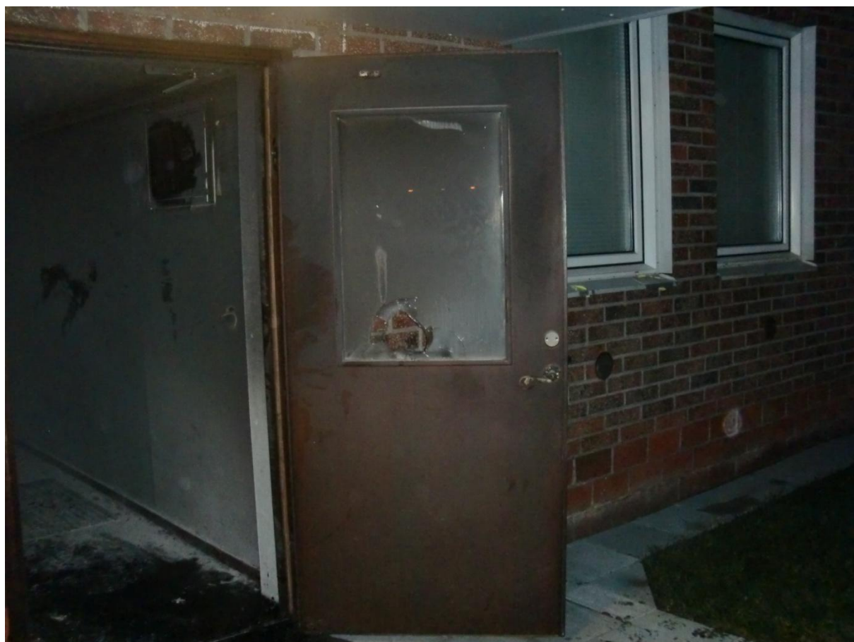
Trapphusets entrédörr med genomgångshål där sprayburken gick igenom rutan.
