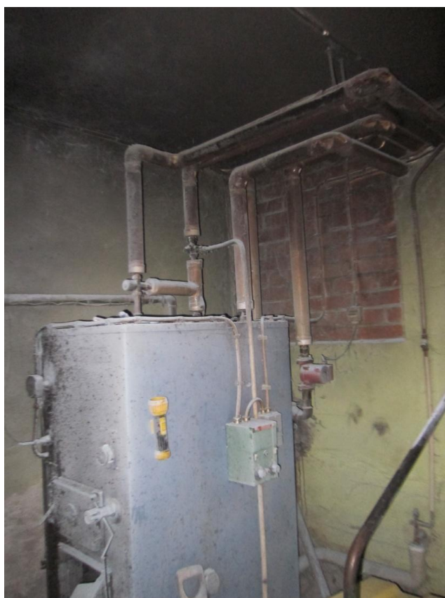
Bild 6. Pannan. Isoleringen runt ledningarna ovanför var värmepåverkade av brandgaserna.
