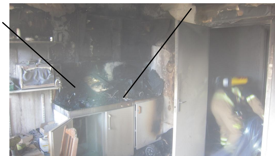
Bild 3. Väggen i anslutning till köket är brandskadat. Spisplattan är påslagen. Ett brand-V syns på väggen vilket indikerar att branden startade här.
