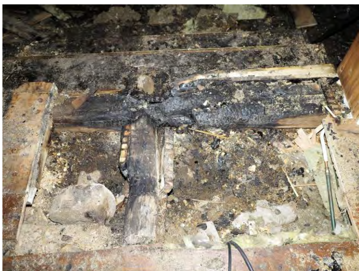
Bild 5. Brandskadade golvreglar i ovankant av trappan.
